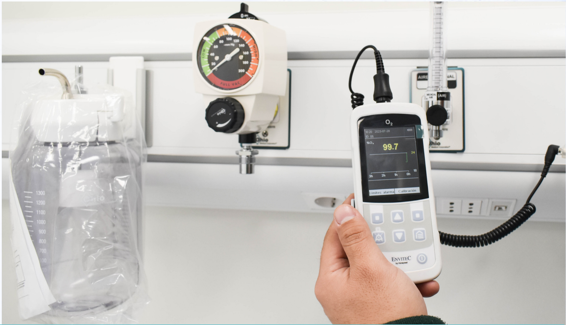
INSTALACIÓN. Actualmente, las CPI (Canaleta Porta Instalaciones) de las salas de Hospitalización ya están habilitadas con las tomas murales de gases clínicos, frascos de aspiración, flujómetros y vacuómetros.
